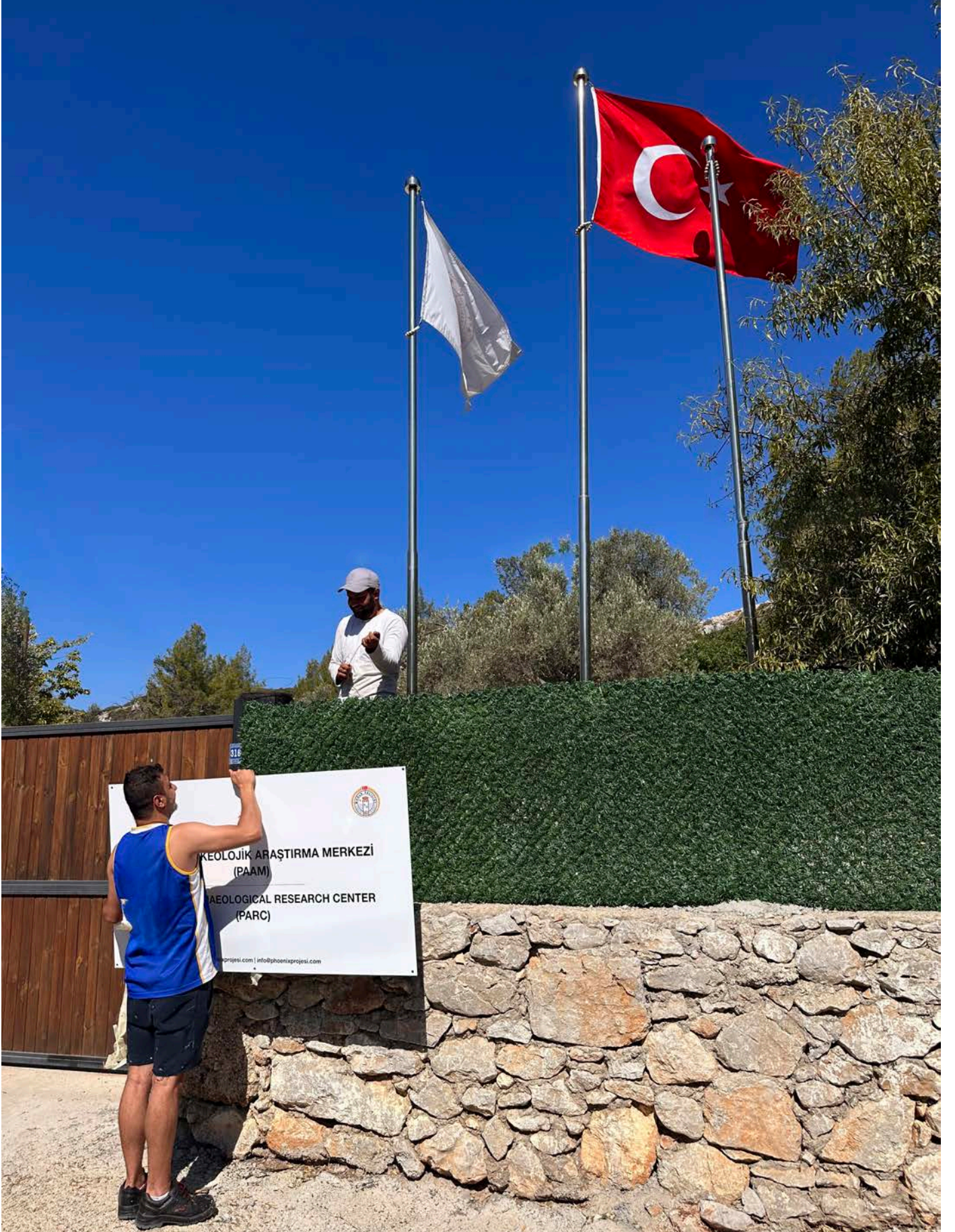
PAAM altyapı ve üstyapı çalışmaları. Fotoğraf: Asil Yaman / PAAM infrastructure and superstructure work. Photo: Asil Yaman
